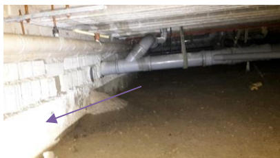
Foto inpanidige kruipruimte met fundering (zie pijl)
